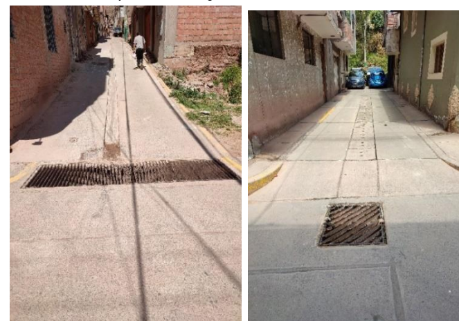
Imagen N° 48: Canal de evacuación de aguas pluviales de pasaje Qorimiray y el Pasaje Justicia en regular estado de conservación
