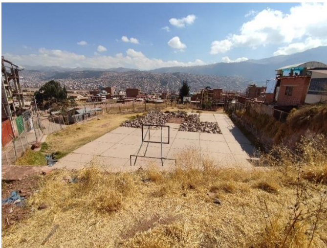
Imagen N° 33: Losa deportiva en muy mal estado de conservación en la A.P.V. UVIMA VII Elvio Miranda Zambrano
